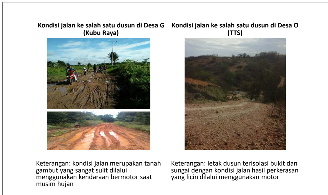
Gambar 3. Kondisi akses jalan di desa studi di Kubu Raya dan TTS
